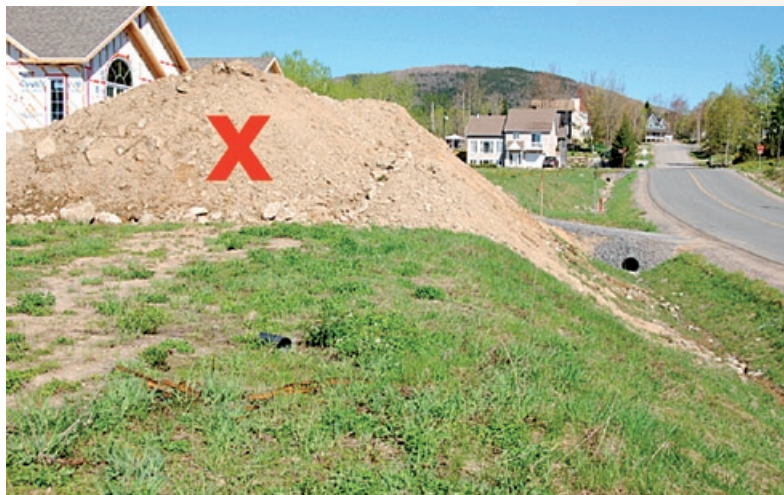
Figure 3 – Entreposage fautif de tas de déblais
