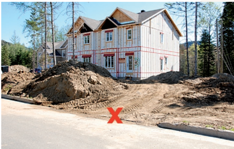
Figure 4 – Accès au chantier sans stabilisation
